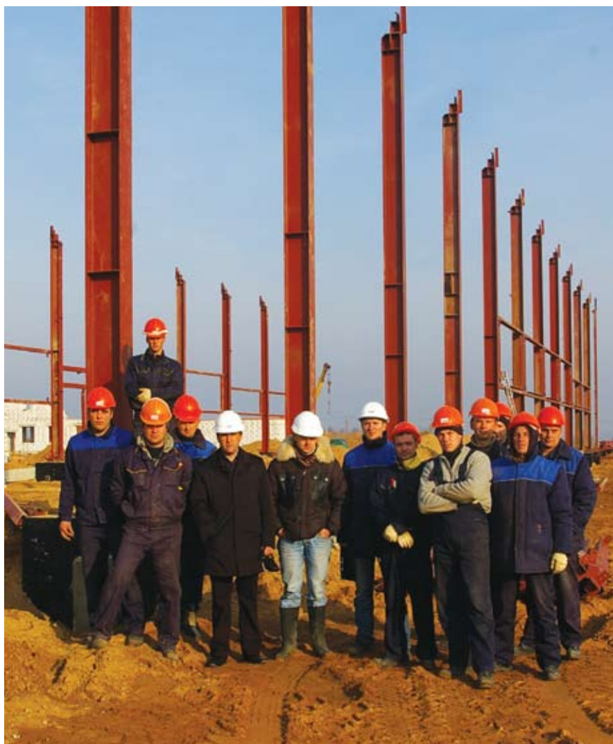
Главный инженер Д. Киселенко со строителями на строительстве склада «Август Бел» площадью 2200 м 2 в районе Минска (Беларусь)
